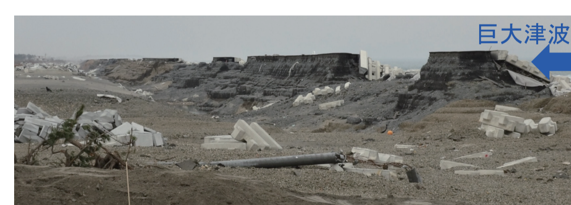
東日本大震災の津波により決壊した防潮堤
