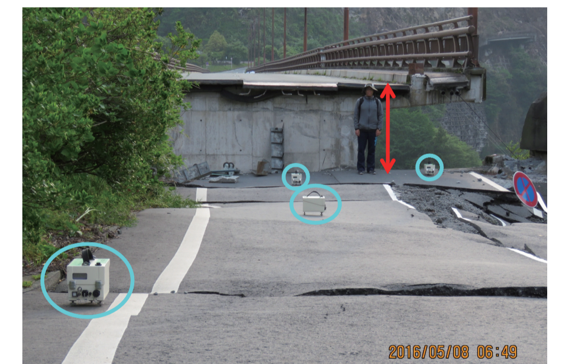
道路地盤の大規模沈下と臨時余震観測の実施
